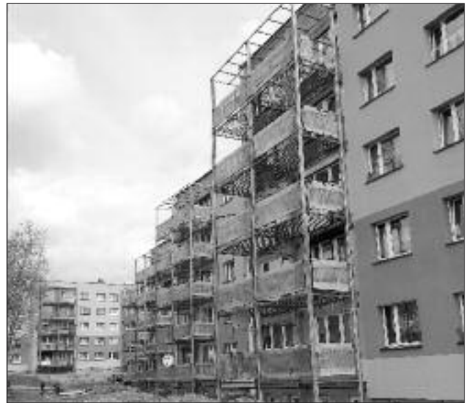
W szybkim tempie posuwa się montaż konstrukcji balkonów tarasowych przy ul. Bielszowickiej 91 w Rudzie Śląskiej.
